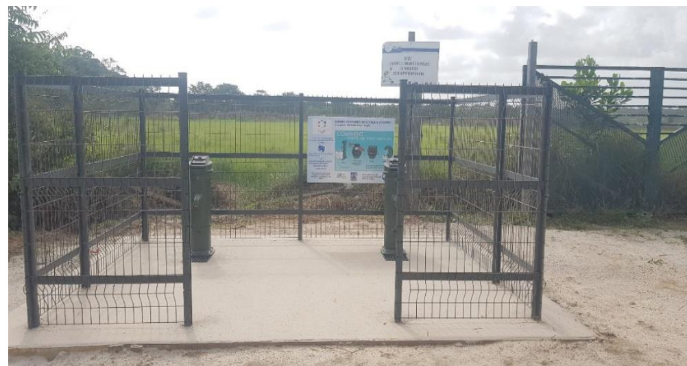
Figure 7: Photo de la plateforme de bornes fontaines domestiques de l'avenue du Pic Saint-Loup à Macouria (parcelle AW394)
