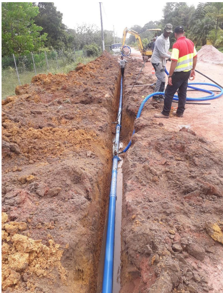
Figure 4 : Pose de la conduite eau potable dans une tranchée ouverte lors des travaux d'extension du réseau à Elysée
