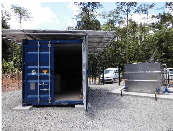
Figure 19: Unité de potabilisation de Favard
