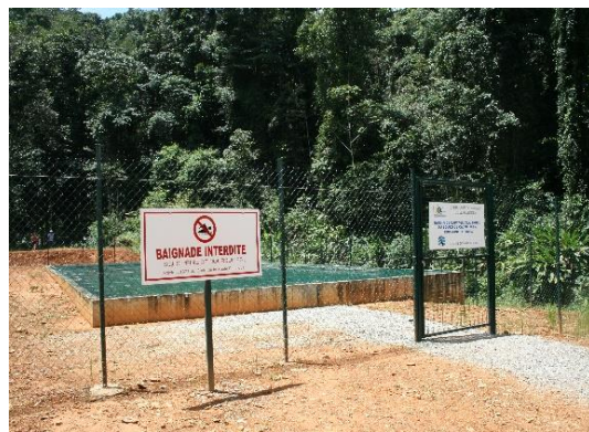
Figure 18: Captage de l'usine de Cacao
